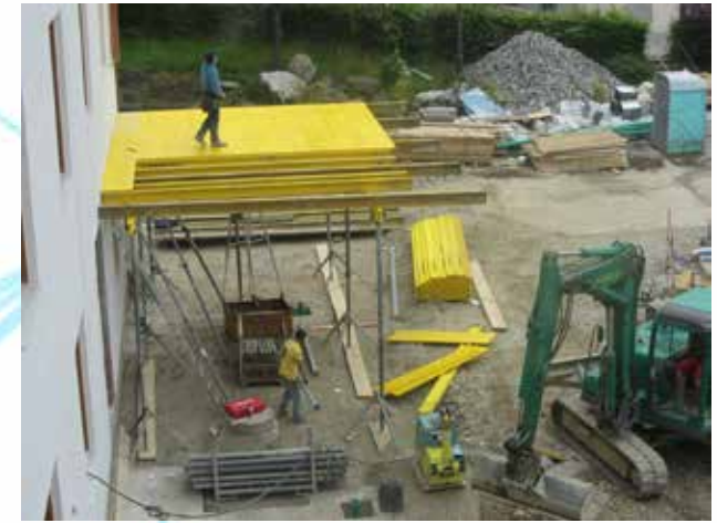
...das wird keine Dachterasse - sondern ein Vordach...
